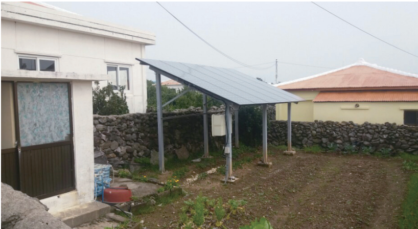
가파도는 풍력발전기 2기를 가동하고, 37가구에 태양광 발전기를 설치했다.
